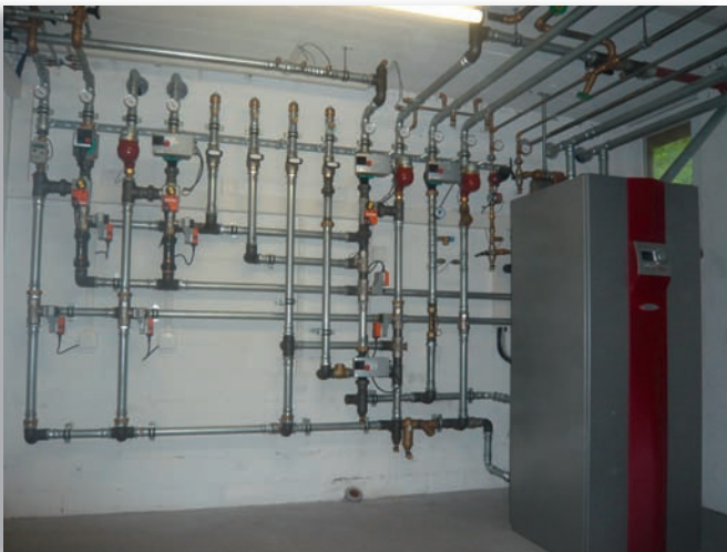
Heizraum NACH der Sanierung mit HP28S40W-M-WEB
