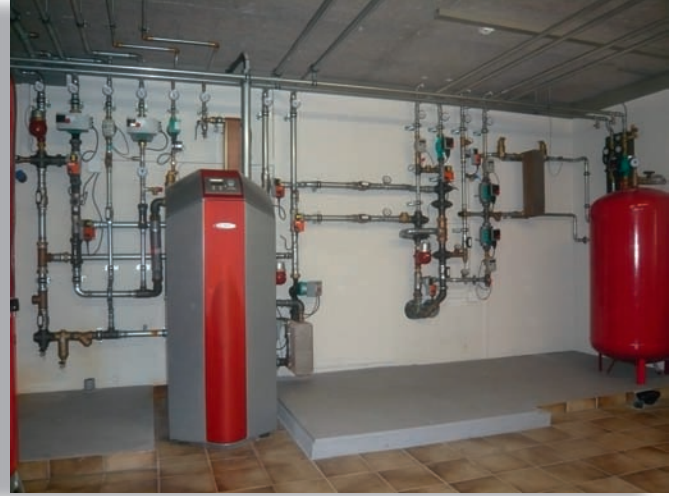
Heizraum NACH der Sanierung mit HP20S25W-M-WEB
